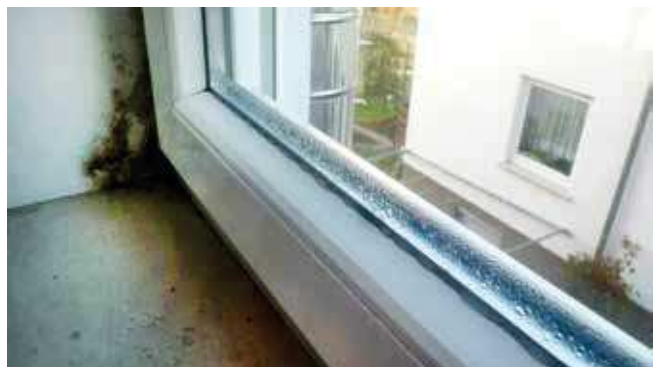
Bild 1 – Beschlagene Fensterscheiben sind ein Zeichen für Tauwasserausfall.
